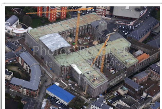
(photo aérienne Bocquet prise en 2014) La Financière Vauban a refait toute la toiture selon le modèle original.
